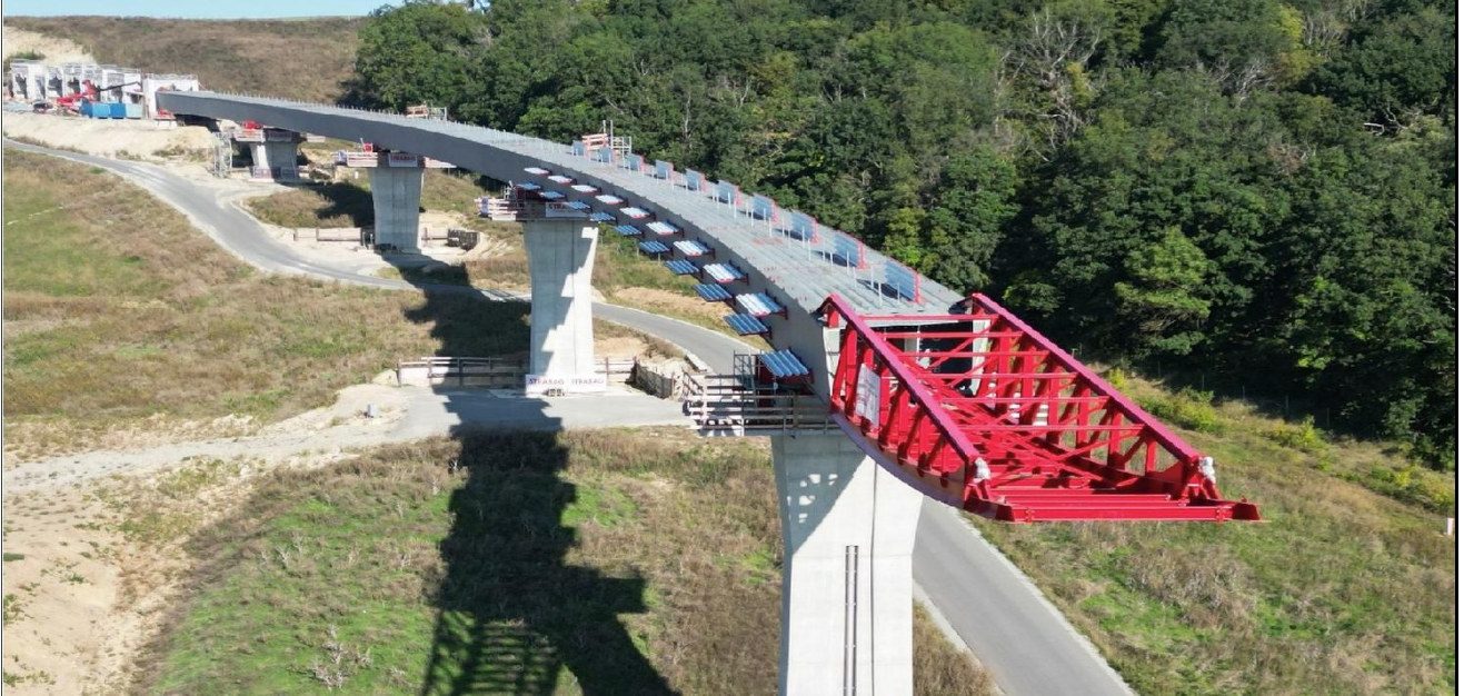
Stahlhohlkasten mit Windleitblechen und Vorschubsnabel
